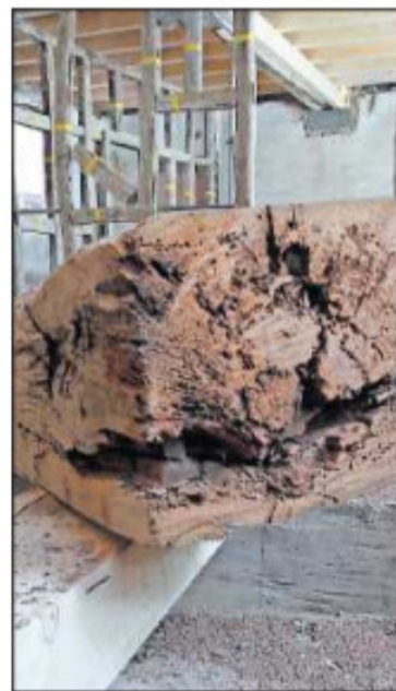
Ein zerstörter Eichenbalken. FOTO: VAN
