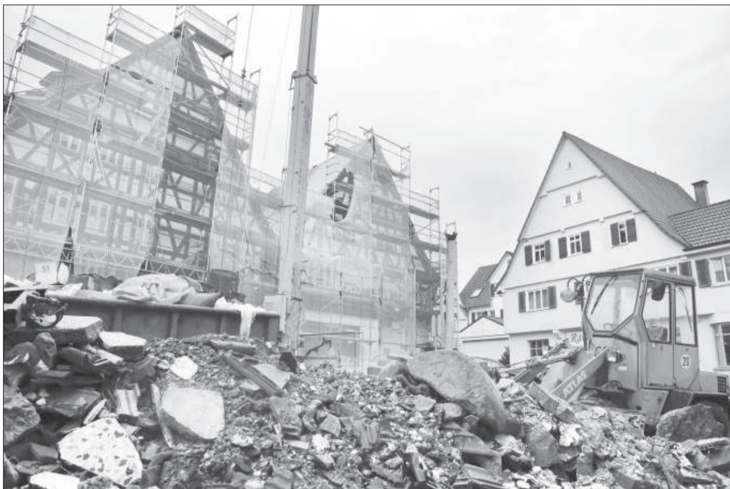
Das Haus Brunnengasse 5 (Mitte) ist in einem weit schlechteren Zustand als ursprünglich angenommen.
